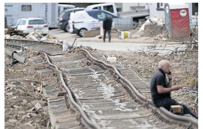
Alles verbogen: die Gleise der Ahrtal-Bahn nach der Flutkatastrophe.
